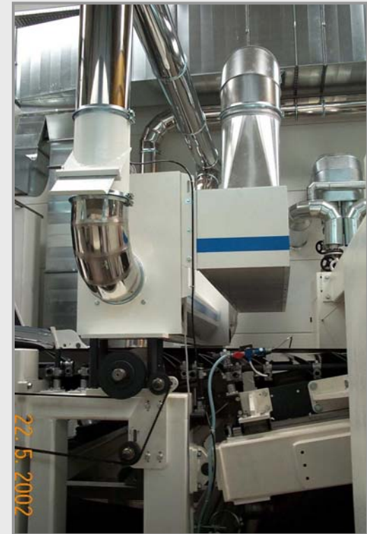
Laminar flow Diffuser Box - LDB, am Kalender-eintritt (mit Start- und Notabsaugung)
